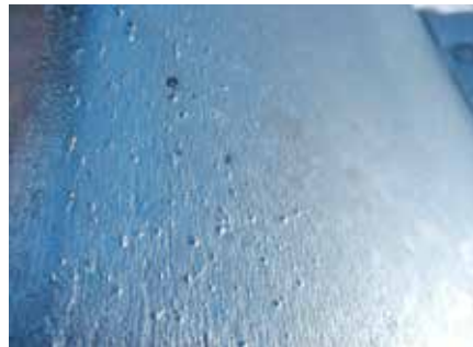
Voorbeeld van overwalsingen welke zichtbaar zijn geworden na het discontinue thermisch verzinken
